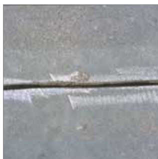
Estado de la junta: seca, sana, limpia y exenta de partículas sueltas.
