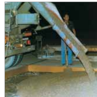
Vertido del hormigón fresco (antes de que la resina de unión haya endurecido totalmente).
